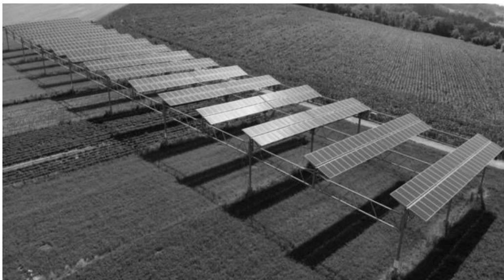
Рис. 3. Установленные над полями фотопанели
